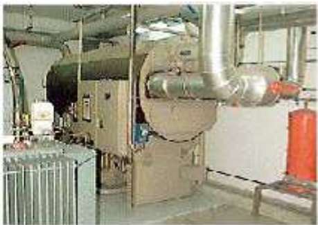
Machine à absorption de 500 kW raccordée sur la cogénération.
