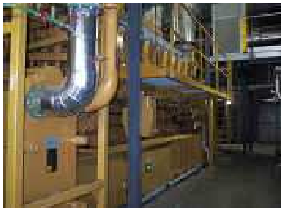
Moteur à gaz
